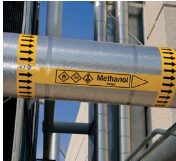
Marquage de tuyauteries
