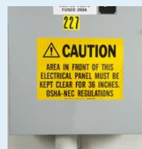
Panneaux de danger
