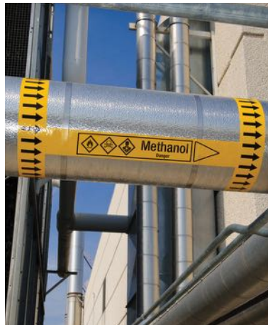
Marquage de tuyauteries
